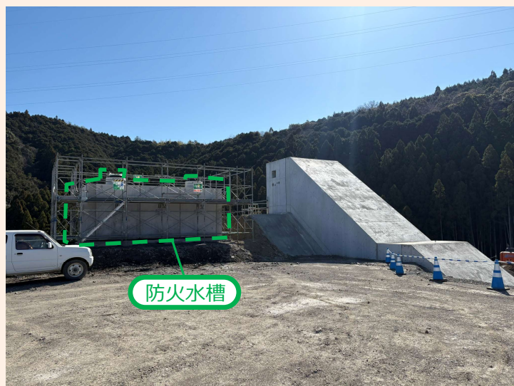
集水ピット周辺の状況（令和8年3月11日撮影）
