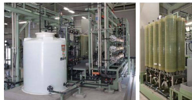
▲逆浸透膜装置
